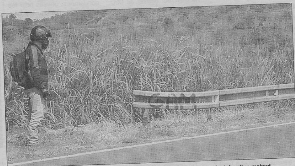
Au pont de la Ouatchoué, l'extrémité des glissières peut se trouver sur la trajectoire d'un motard qui glisserait sur la chaussée : c'est « le guillotineur ».
